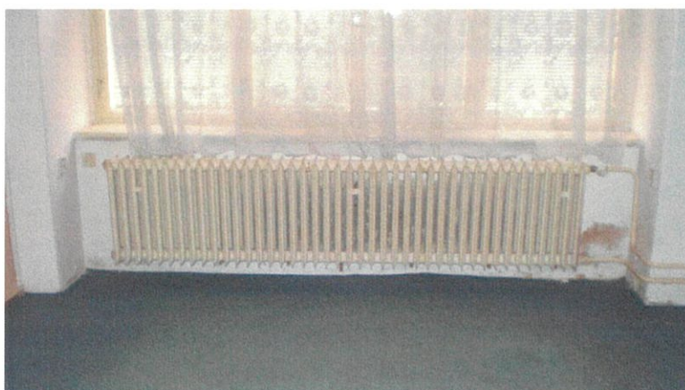
Typické článkové otopné těleso objektu s termoregulačním ventilem a osazenou termohlavicí
